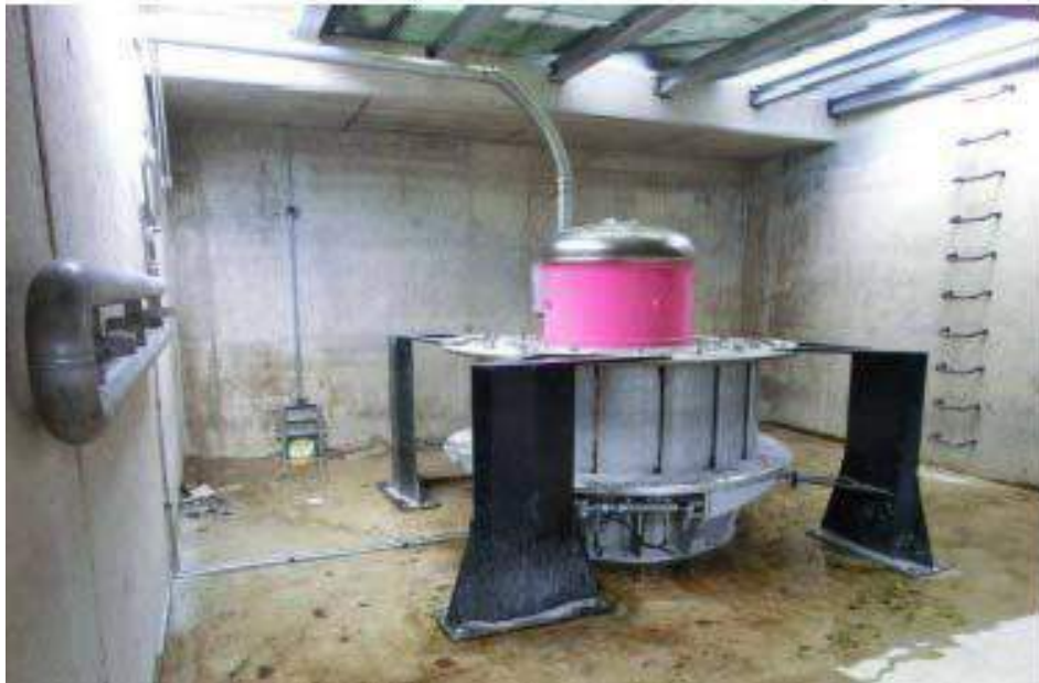
Slika 23. Izgled ugrađene DIVE turbine.
